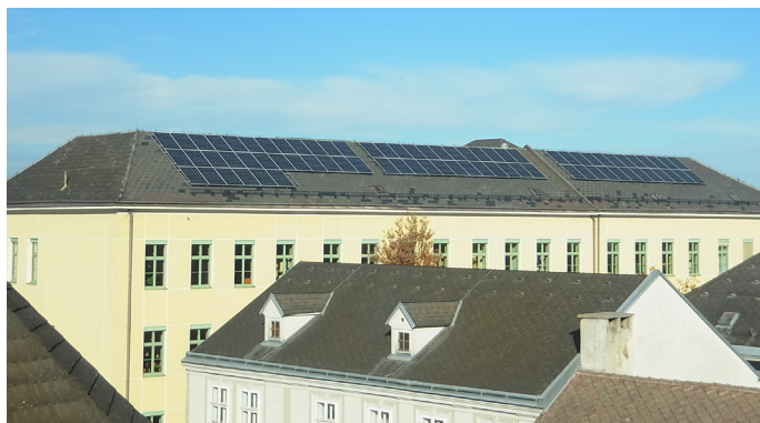
Photovoltaik auf Schulgebäude, © Gemeinde Ober-Grafendorf
