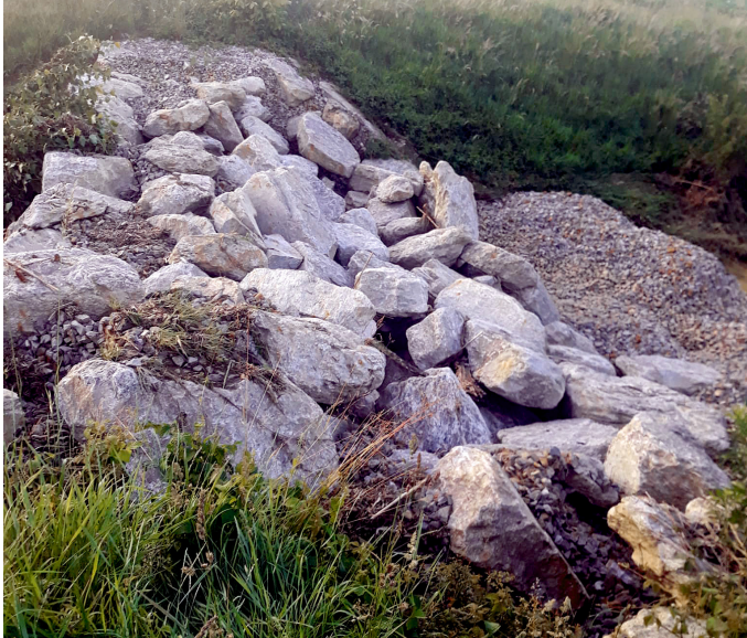
Eines der vom Starkregen im Juni 2024 zerstörten Rückhaltebecken
